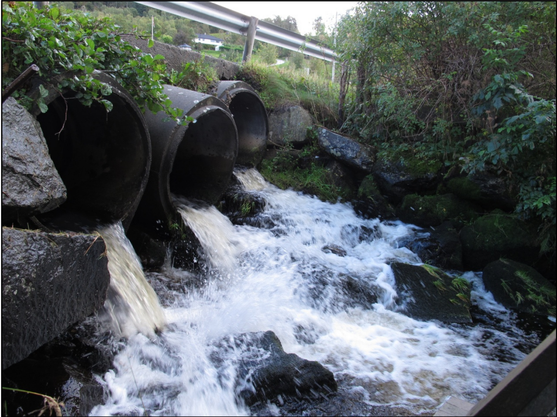
Figur 6.2. Utgang av kulvert i Strandåna. Fall rett i blokk. Nærmeste satspunkt ligger ca. en meter i fra fallet til de nærmeste rørene. Fisken går trolig opp i røret lengst bort i bildet ved veldig høy vannføring.
