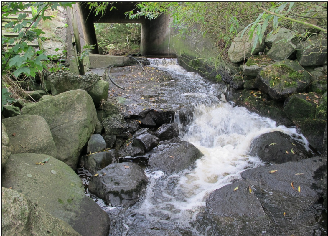
Figur 6.8. Vandringshinderet består av fall i blokk uten satspunkt, betongsklie med lav vanddybde og en terskel det ikke er mulig å ta sats over.
